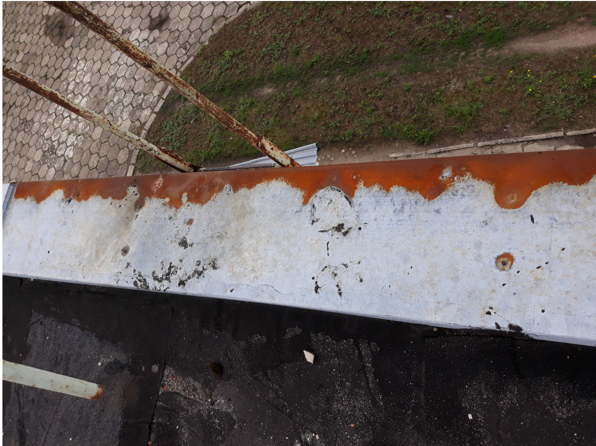
Zdj. nr 7 obróbki blacharskie na budynku internatu.
